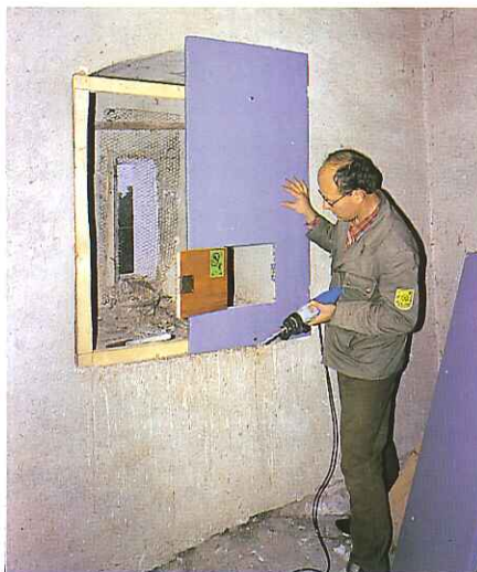
Výklenek v kostelní zdi lze využít k vytvoření bezpečného hnízdního prostoru
